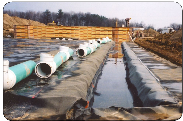
Figure 4. Sections de tuyaux de PVC attendant d'être raccordées en vue de former un système de transfert de fumier liquide étanche entre le réservoir du bâtiment d'élevage et l'installation d'entreposage du fumier externe.
